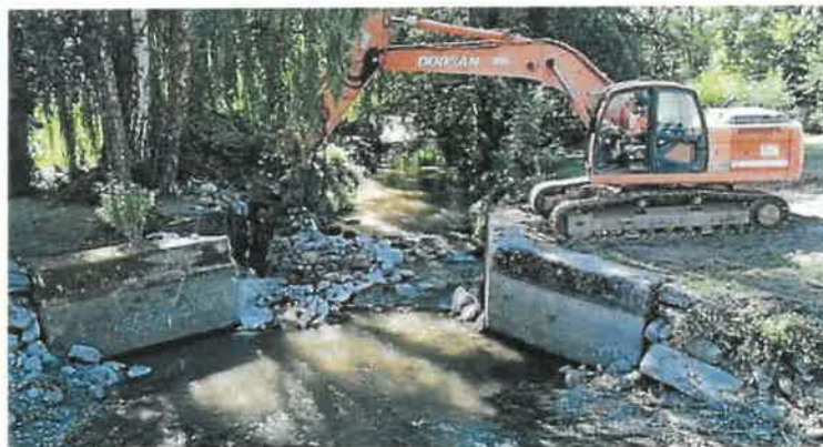
Les travaux de suppression du barrage de la Saugère et le réaménagement de la rivière dureront deux mois et demi.
