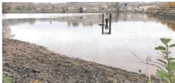
La pompe visible depuis la baisse de niveau d'eau de l'étang.
